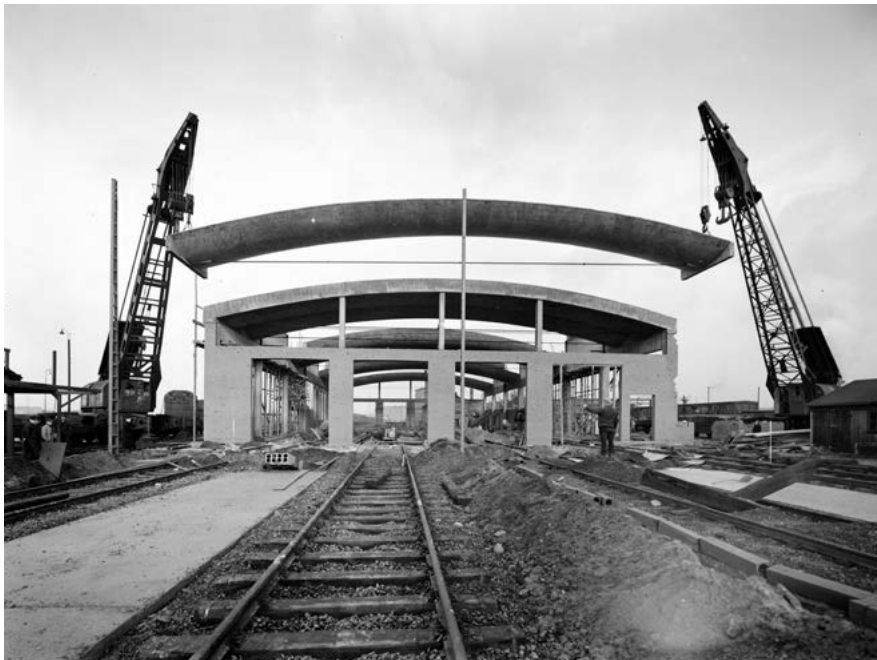
Zwei Eisenbahnkrane decken die Güterwagenreparatur in Wilhelmsburg mit vorgefertigten Hyparschalen. Foto: Otto Rheinländer / Hamburgisches Architekturarchiv
