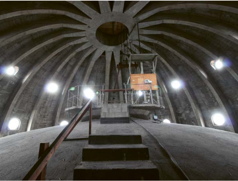
Die Auferstehungskirche in Barmbek hat zwei Eisenbeton-Kuppeln: Eine Rippenkuppel trägt das Dach und eine Schale deckt den Kirchenraum ab. Foto: Sven Bardua, 2020
