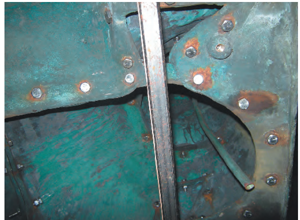
Abb. 27: Frau: Blick in die Innenkonstruktion: Die verrosteten Schrauben sind ausgetauscht worden.
