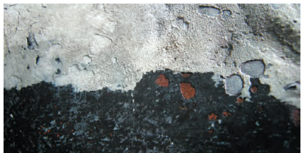
Abb. 18: Mann: Schrittweise Freilegung der Oberfläche. Unter der Kalkkruste befinden sich Ausbrüche der Patina.
