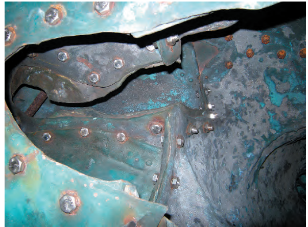
Abb. 26: Frau: Blick in die Innenkonstruktion: Die verrosteten Schrauben sind ausgetauscht worden.
