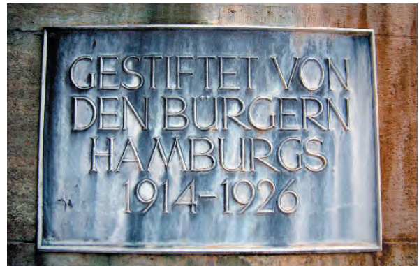
Abb. 50: Stiftertafel: Zustand vor der Restaurierung. Verkrustete Oberfläche.
